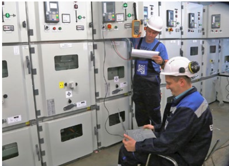
■ Лазар Станчић и Никола Ерић проверавају 6 kV ћелију
