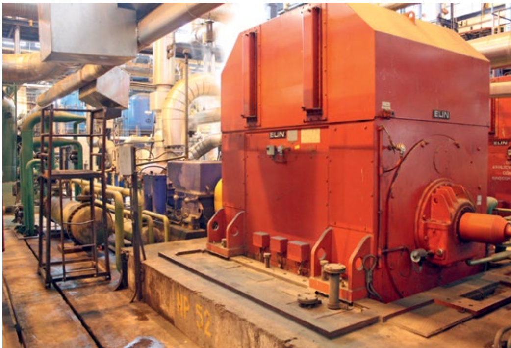
■ Електромотор турбонапојне пумпе
