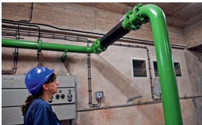
Систем за спречавање развоја љуштурске шкољке за бољи проток хлађења блок-трансформатора
