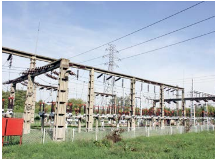
■ Разводно постројење 110 kV
