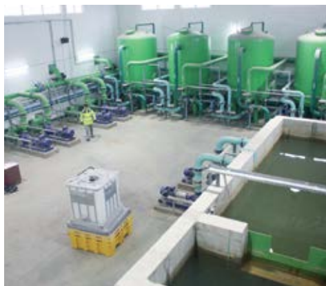
■ Постројење за пречишћавање заугљених вода
