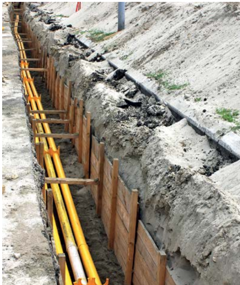
■ За успостављање даљинског управљања и заштите, упоредо са 110 kV подземним водом положен је и оптички кабл
