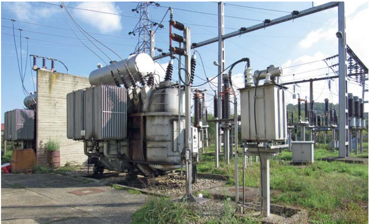
■ ТС „Лешница“ 110/35 kV/kV, једна од пет ТС које ће бити реконструисане
