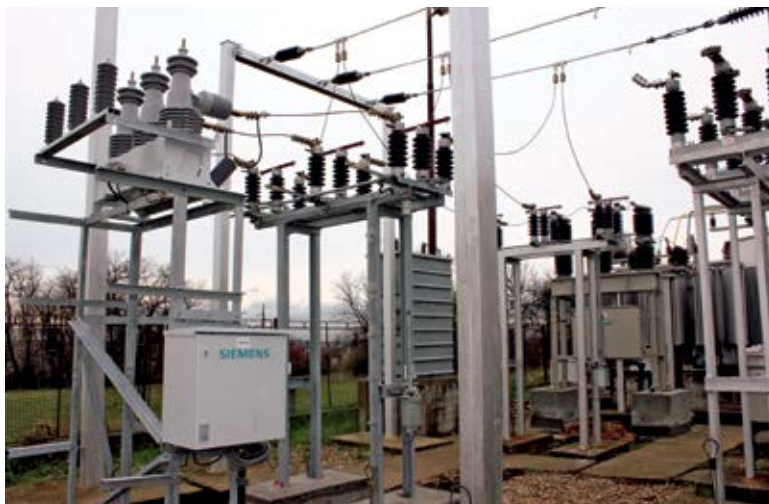
У далеководна 35 kV поља уграђени су интелигентни линијски прекидачи
