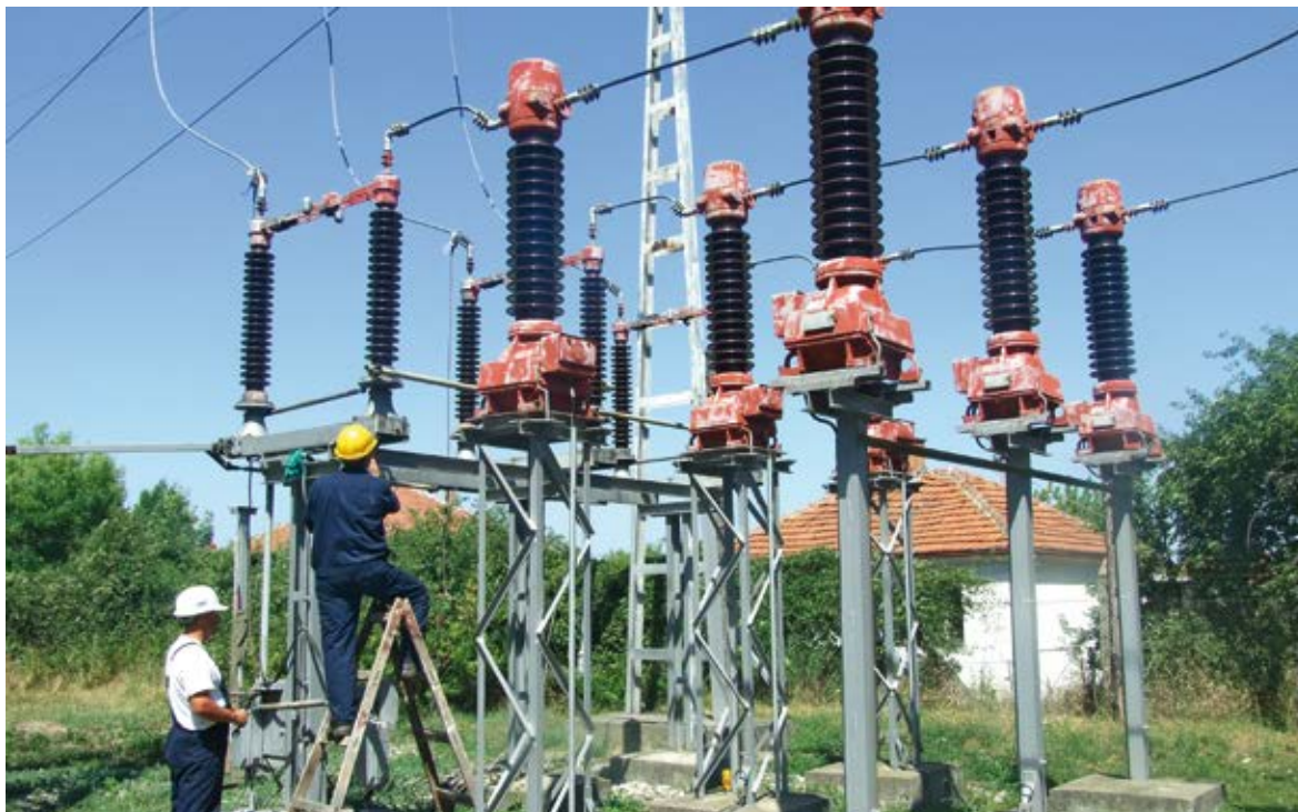
■ Проверен рад прекидачке опреме, обављена су неопходна подмазивања и замена уља на малоуљним прекидачима
