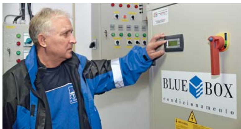
■ Контрола рада топлотне пумпе
