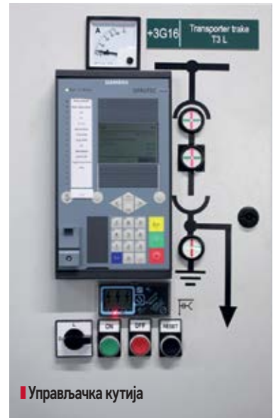
Разводно 6 kV постројење опште групе
