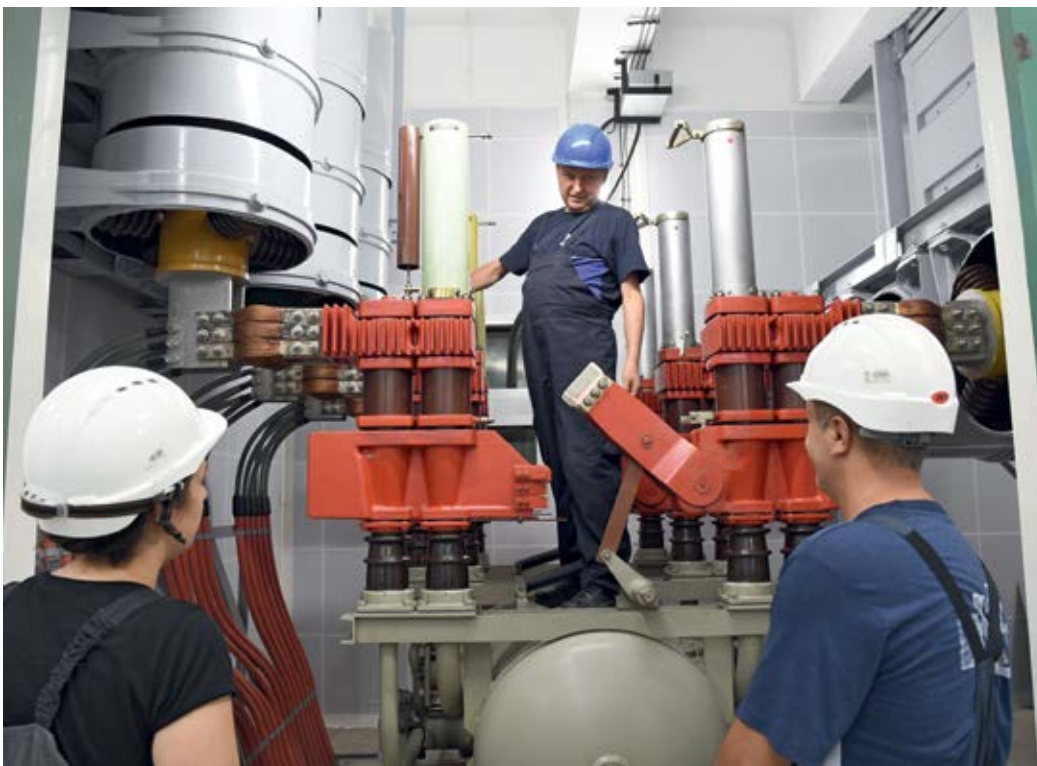
■ Генераторски прекидач је прошао сва испитивања
