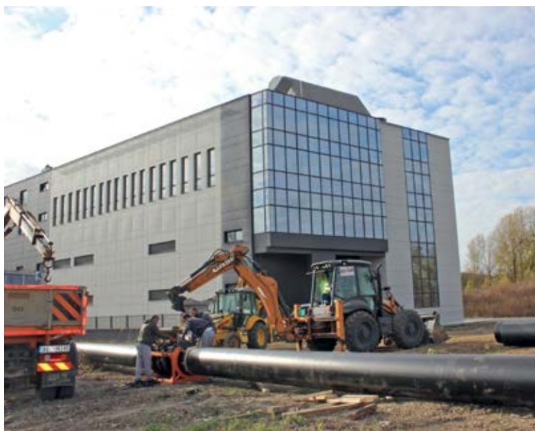
■ У току су радови на уклапању нове трафостанице на Аутокоманди у 10 kV мрежу
