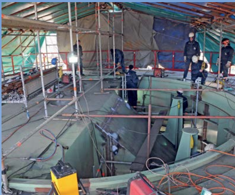
Радови на изради темеља за зграде у оквиру новог дробилишног постројења на депонији
