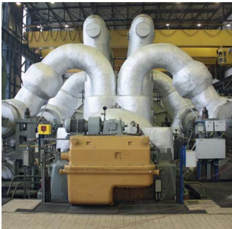
■ Турбоагрегат блока Б2
