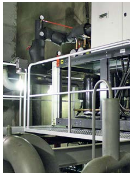
■ Расхладни агрегат у котларници између блокова
