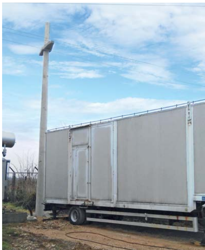
Мобилна трафостаница 35/10 kV обезбеђује потрошачима непрекидно напајање електричном енергијом током извођења радова
