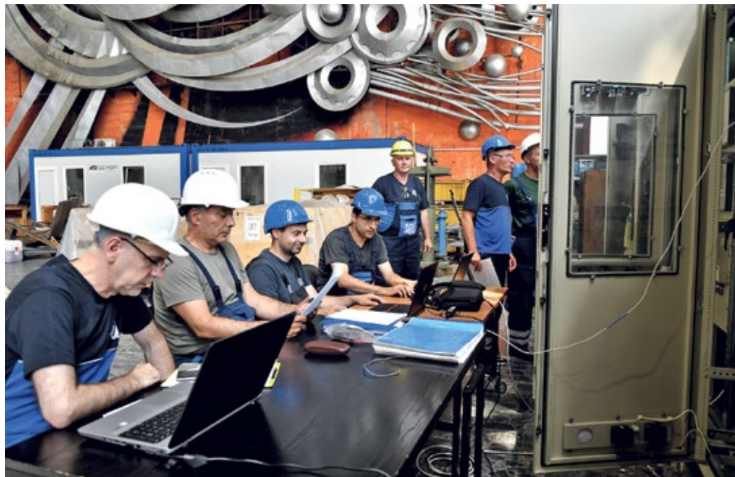
■ Примарна испитивања електричних заштита агрегата пре синхронизације на мрежу
