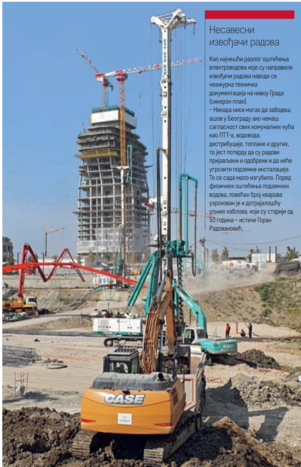
■ Изградња нове и заштита постојеће мреже ободних саобраћајница у Булевару Вудро Вилсона (Београд на води)
