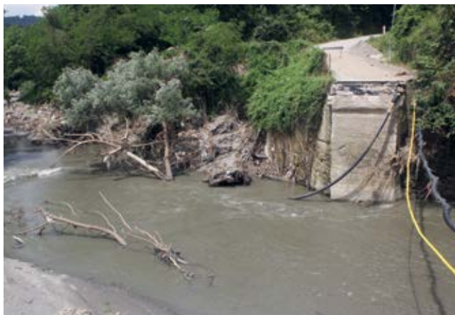
■ Исправан 10 kV кабл преко срушеног моста
