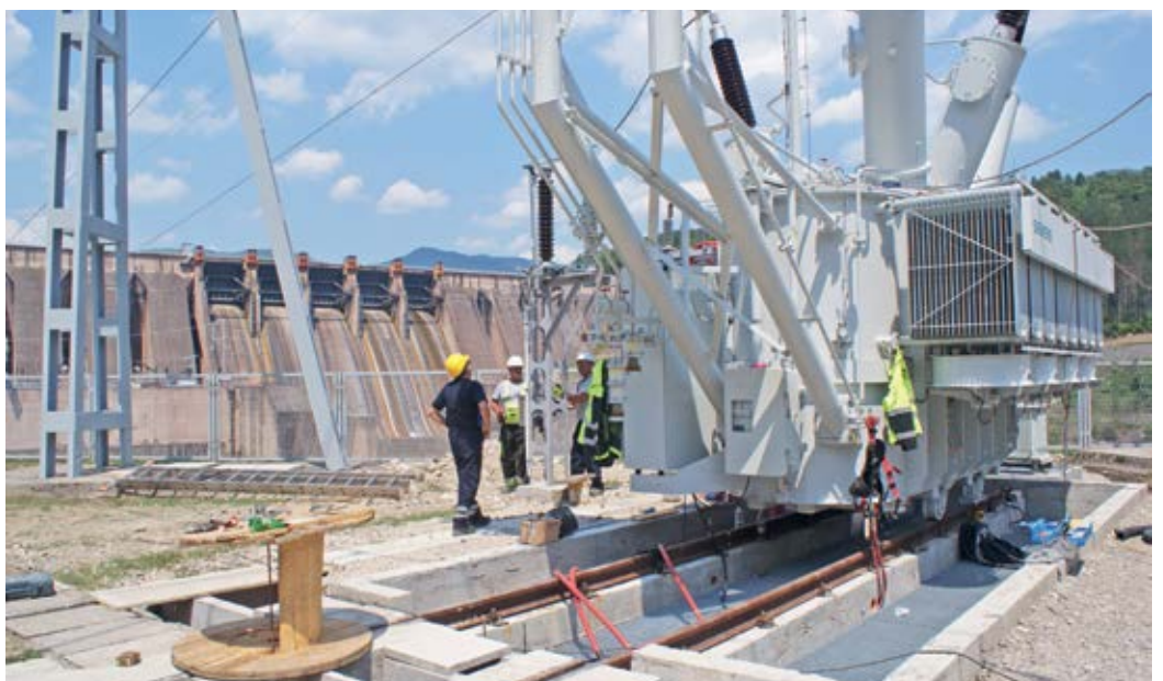
■ Проширење разводног постројења 220 kV
