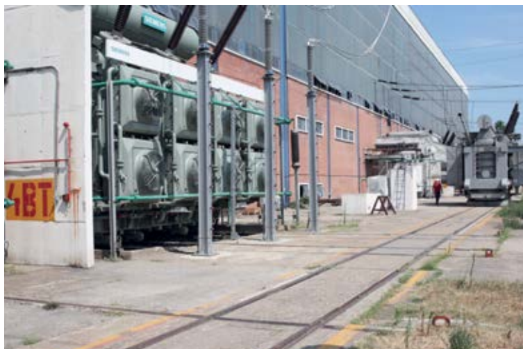
■ Нови трансформатор на блоку ТЕНТ А4
