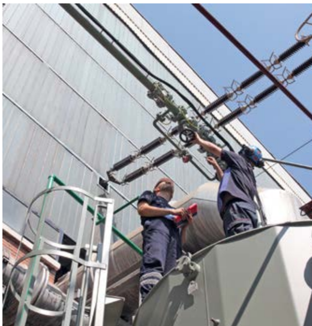
■ Превентивни преглед блок трансформатора шестице
