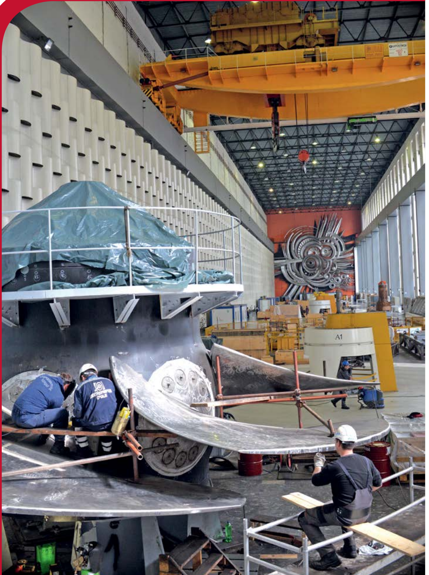
■ Радно коло турбине у машинској хали са агрегатима Хидроелектране „Ђердап 1“
