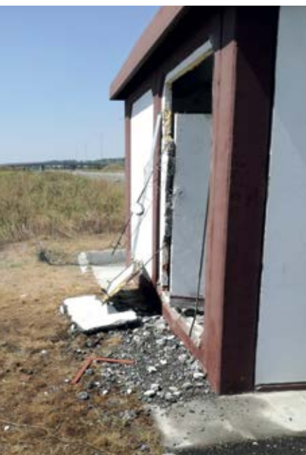
■ Разлупани и одваљени бетонски зидови и опустошена комплетна унутрашњост ТС
