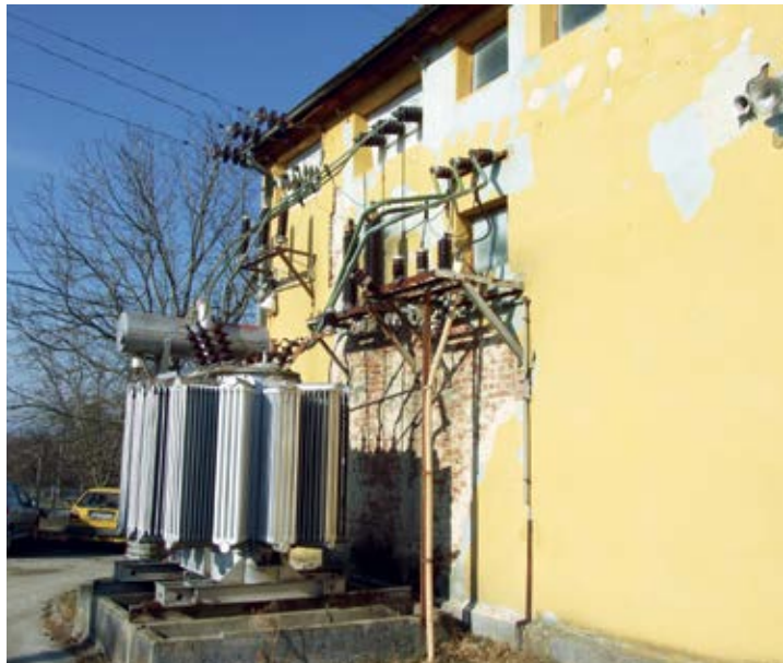
■ Стара ТС 35 kV „Кнић“
