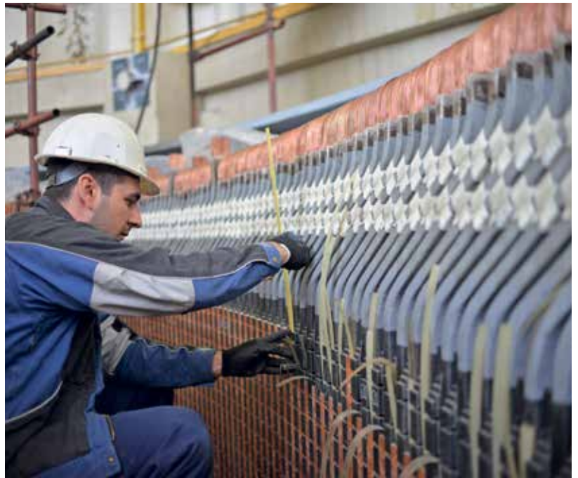
■ Статор главног генератора прошао високонапонска испитивања
