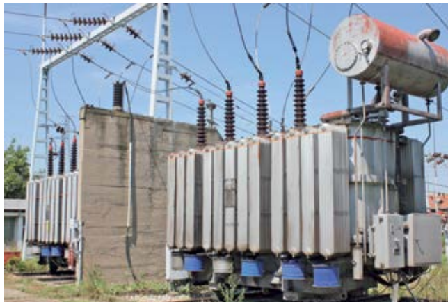
■ Енергетски трансформатор 110-35 kV
