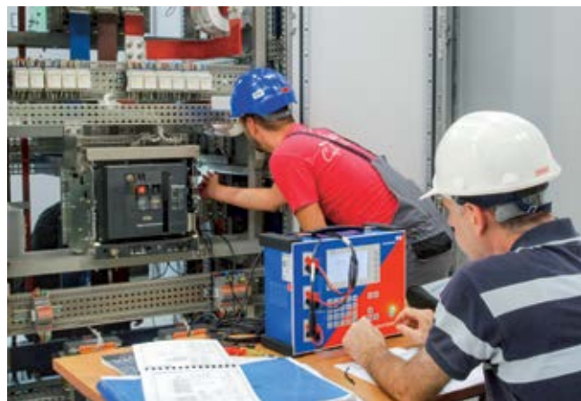
■ Нови уређај за контролу мерних трансформатора
