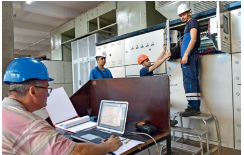
■ Секундарна испитивања заштите 6,3 kV блока 1 и блок-трансформатора БТ1
