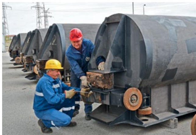
■ Мајстори „Гоша монтаже“ иза себе имају 15 година рада на ремонту у ХЕ „Ђердап 2“
