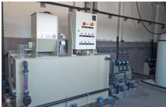
■ Постројење за пречишћавање замазућених и зауљених отпадних вода
