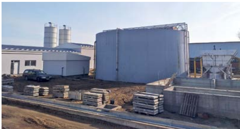
■ Постројење за пречишћавање отпадних вода након одсумпоровања и хемијске припреме воде
