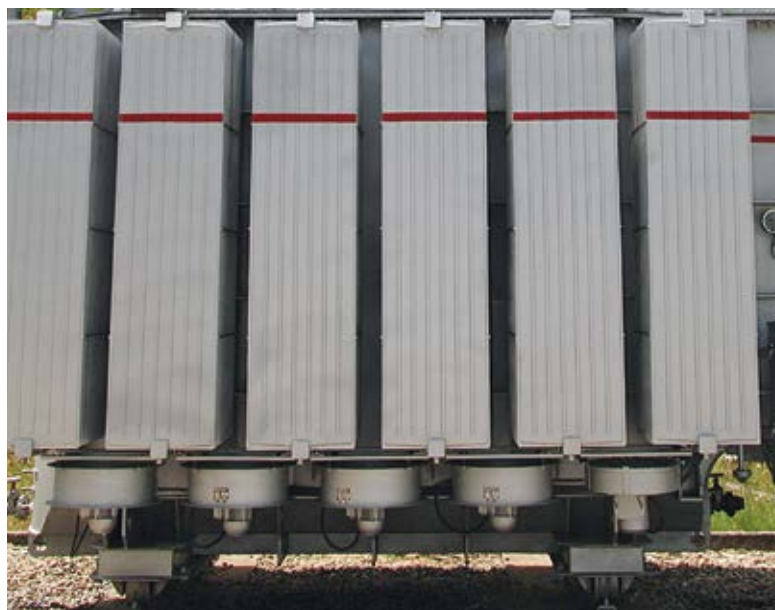
■ Трансформатор 110 kV – систем за хлађење уља
