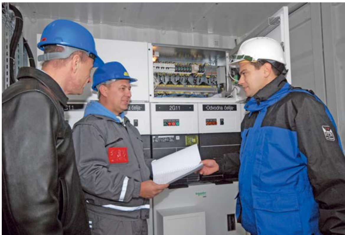
■ Дизел-агрегат је последња линија покретања електране из безнапонског стања
