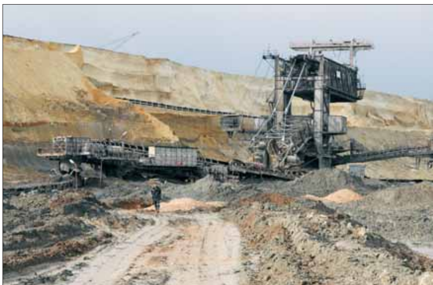
Пуцање угљеног блока је, у једном тренутку, озбиљно угрозило људе и механизацију на Пољу "Д"
